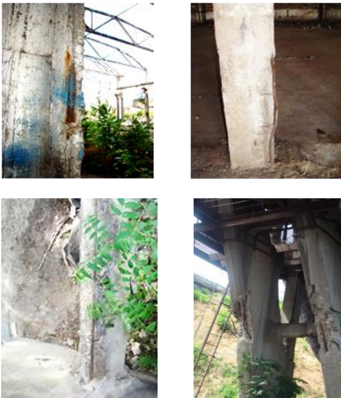
Рис. 1.1. Пошкодження залізобетонних конструкцій
