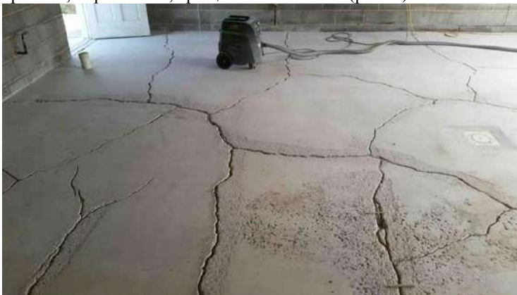
Рис. 2. Механические повреждения пола.
