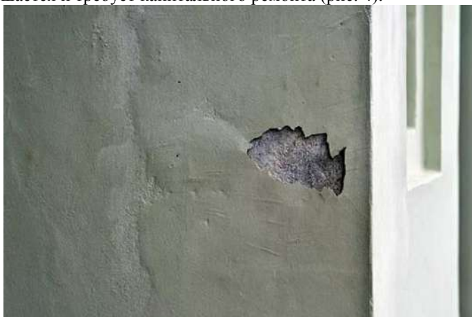
Рис. 3. Отслоение штукатурки на перегородке.
