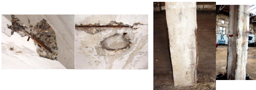
Рис. 1. Пошкодження залізобетонних конструкцій
