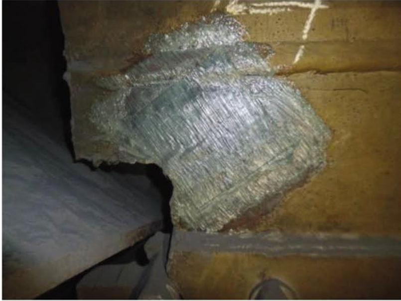
Рис.8 Відремонтована тріщина в корпусі бункера методом консервації
