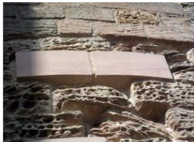
Рис. 2 Поврежденные камни, заменены новыми
