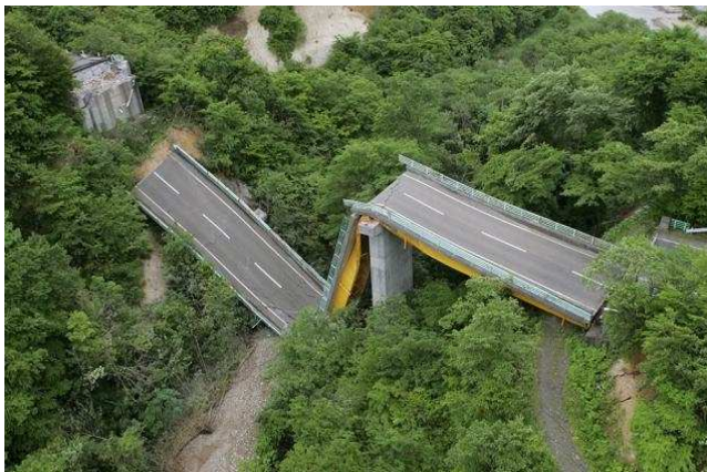
Рис. 1. Повреждение путепровода, вызванное оползнем
