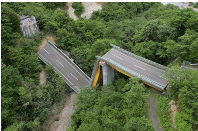
Рис. 1. Повреждение путепровода, вызванное оползнем
