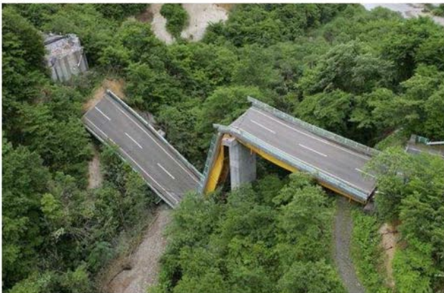
Рис. 1. Повреждение путепровода, вызванное оползнем
