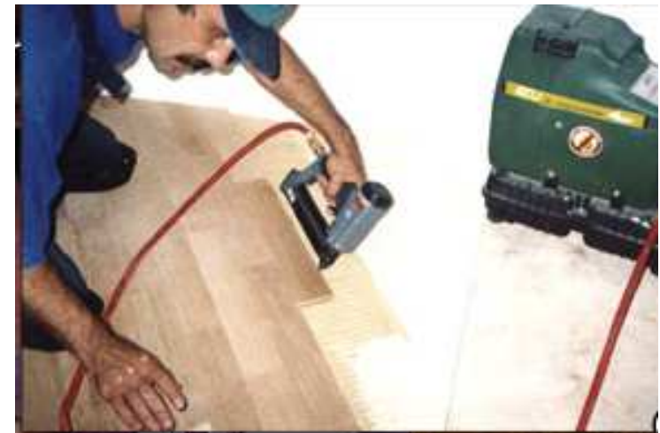
Рис.5.20. Фиксация паркетных планок специальными гвоздями с обжимной головкой, с применением пневматического пистолета
