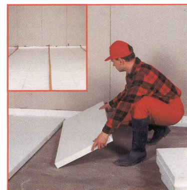
Рис.4.13. Укладывается слой теплоизоляции из пенополистирола или уплотненной минеральной ваты, а потом прикрывают его плотной изоляционной фольгой, которая вместе с изолирующим слоем у стены должна образовывать непроницаемое «корытце».
