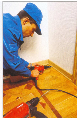
Рис.5.26. Раскрой и крепление плинтусов к стене на шурупы с использованием декоративной восковой шпаклевки
