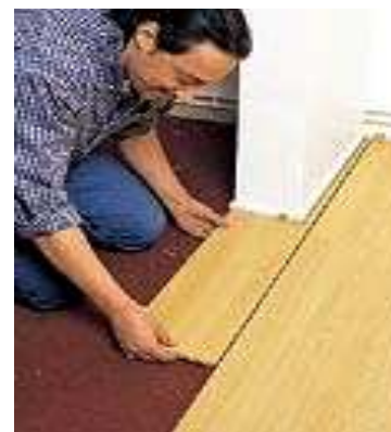
Рис.5.41. Отрезав планку, приложите её продольной стороной к уложенному ряду, вставьте гребень в паз и сместите до упора, предварительно подложив клин для соблюдения зазора
