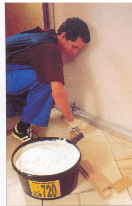
Рис.5.18. Укладка штучного паркета на паркетный клей. Нанесение клея дозированное. Клей на основание наносится зубчатым шпателем.
