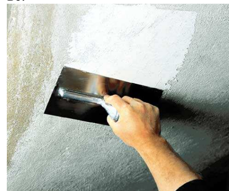
Рис. 1.5. Характерный внешний вид оштукатуренной поверхности перед отделкой и после наложения соответствующей шпатлевки
