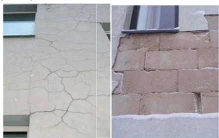
Рис. 9 Разрушение и отслоение штукатурного покрытия от газобетонной кладки [14]
