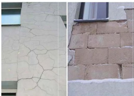
Рисунок 12 Разрушение и отслоение штукатурного покрытия от газобетонной кладки [14]
