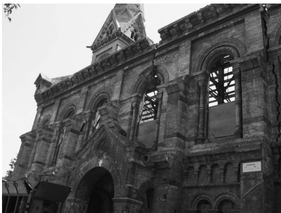
Рис. 6.17. Деформации в продольной стене зала
