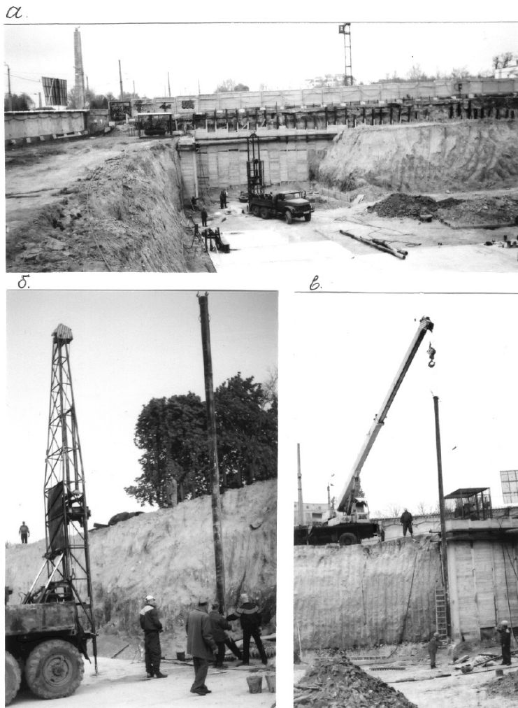
Рис. 4.23. Подготовка испытаний опытными штампами: а) бурение скважин для установки штампов; б, в) монтаж штампостоек в скважины на участках I и II
