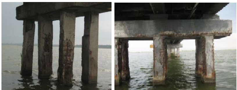
Рис. 1. Интенсивная коррозия опор пролетного строения мостового сооружения от действия агрессивной среды
