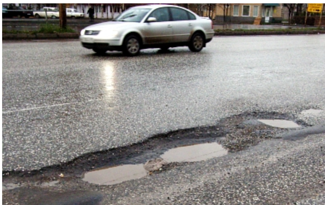
Рис. 1. Состояние дороги после зимы
