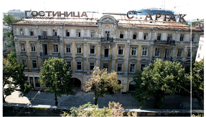
Рис. 10. Фотографія будівлі на початок XXI ст., де зафіксовано "хворий" стан вже "старого" за віком і занедбаного готелю, який на даний час вже не існує і на його місці знаходяться торговельні ряди з дрібницями для туристів
