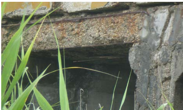
Рис.2. Значительное поверхностное разрушение бетона с оголением арматуры на водопропускном сооружении Каланчакская труба
