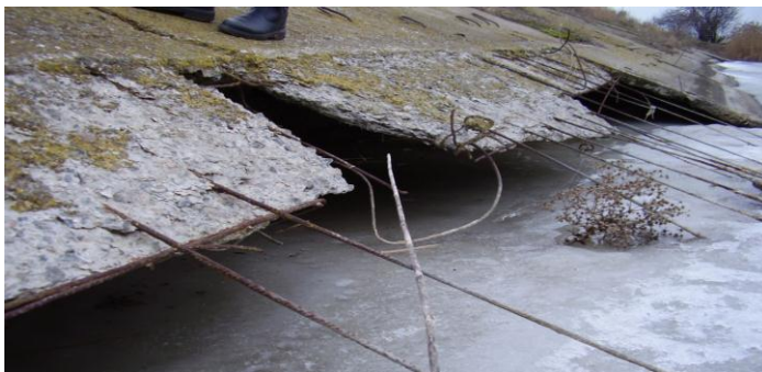
Рис 1. Разрушение откоса правого берега.
