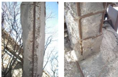
Мал.1. Фото пошкоджень опор шляхопроводу в місті Одеса.
