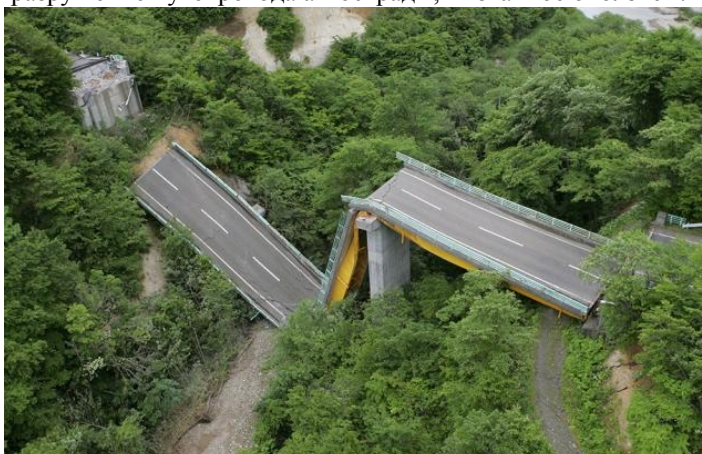
Рис. 1. Повреждение путепровода, вызванное оползнем
