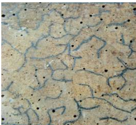
Рис.3. Технологическая поврежденность керамзитобетона на керамзитовом песке
