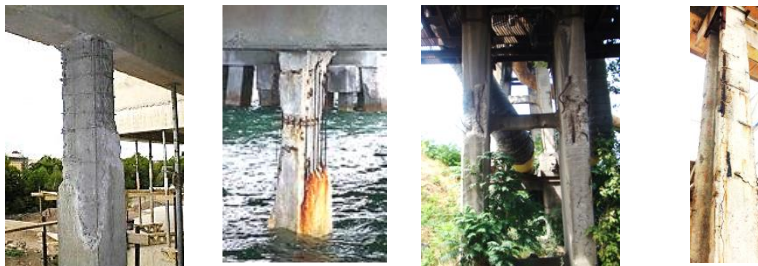
Рис. 1. Руйнування бетону в стиснутих елементах
