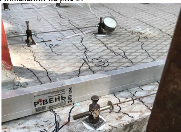
Рис. 3. Фрагмент плити із позначеними тріщинами
