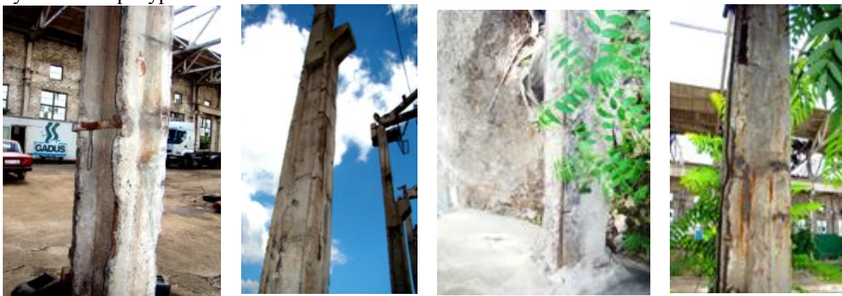
Рис. 1. Приклади пошкодження залізобетонних стиснутих конструкцій складного профілю
